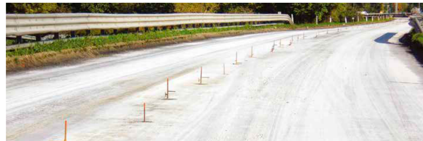
La stesa della geogriglia sopra il conglomerato bituminoso di base Alto Modulo
